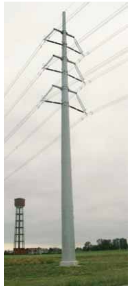
Nella foto: un traliccio «monostelo» di Terna.
